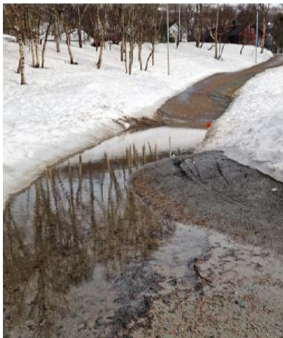
↑ Overvannsproblematikk vinter ved nyanlagt snarvei/adkomst inn mot skolegården på Selnes skole.
